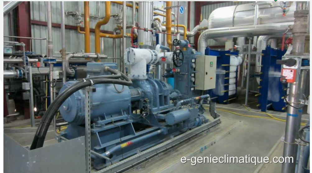
2022 : PRODUCTION GLYCOL -4° C NH3
